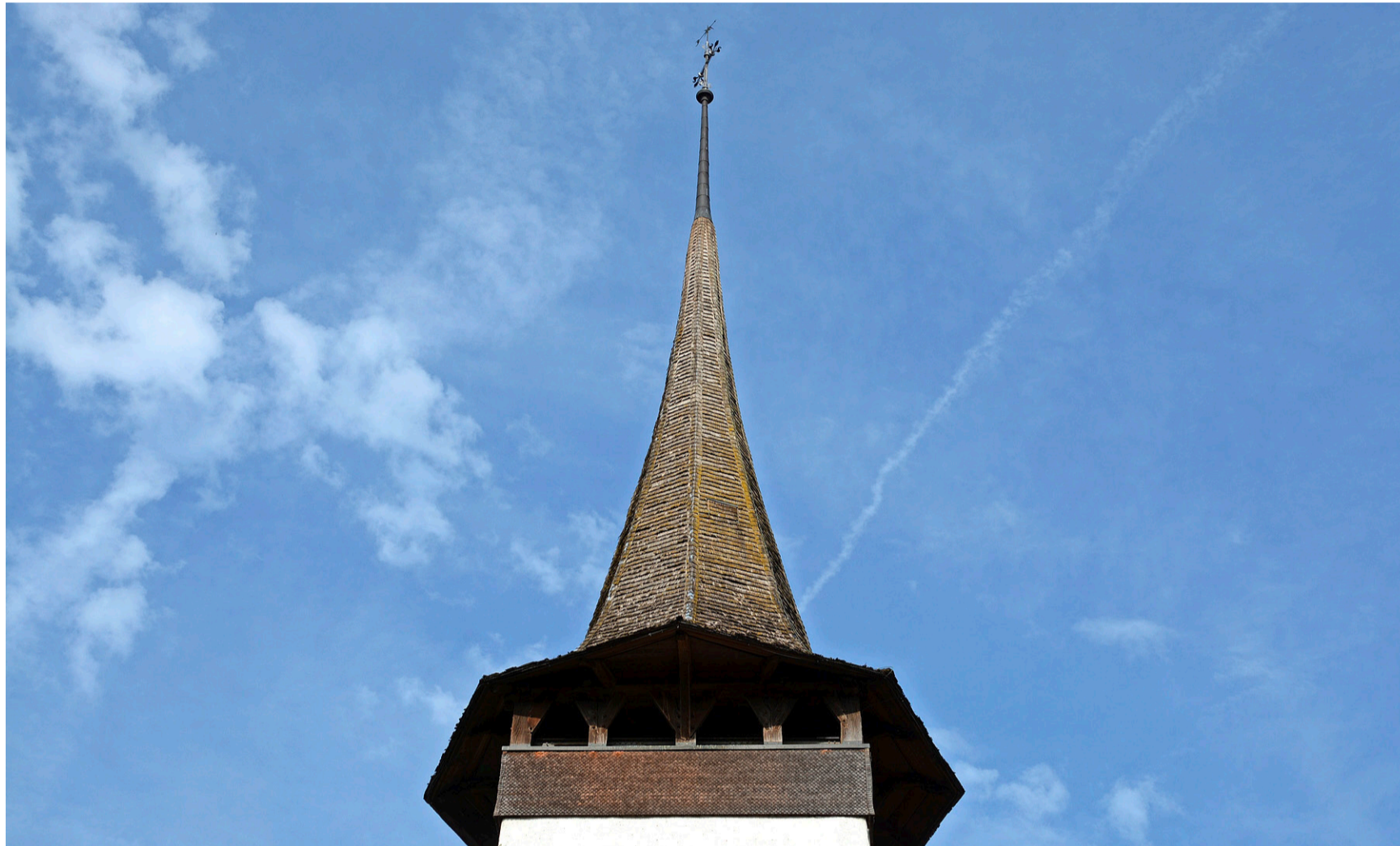
Das Dach des Kirchturms von Kerzers ist in einem schlechten Zustand und muss erneuert werden.
